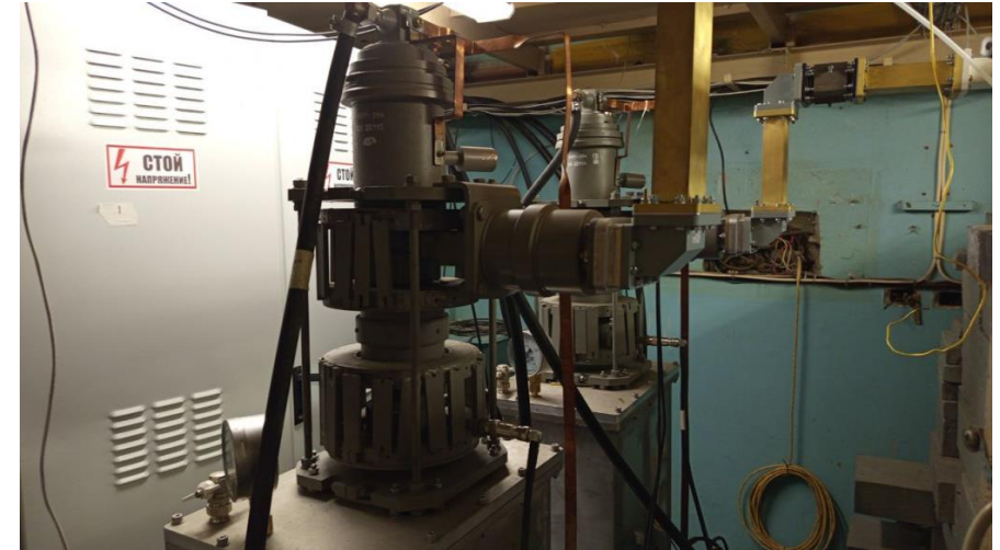
Рис. 7. Клистрон КИУ-284 и повышающий трансформатор.
